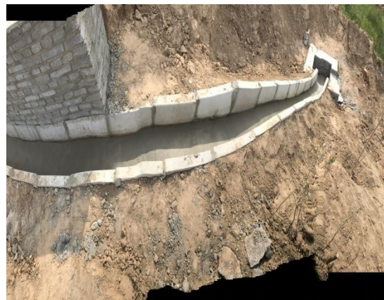
排水沟末端水窖
